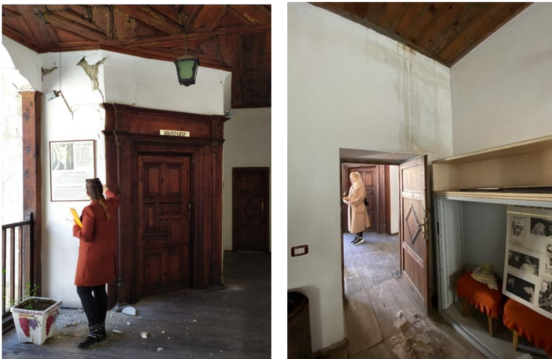
Foto e realizuar në objekt pas tërmetit
