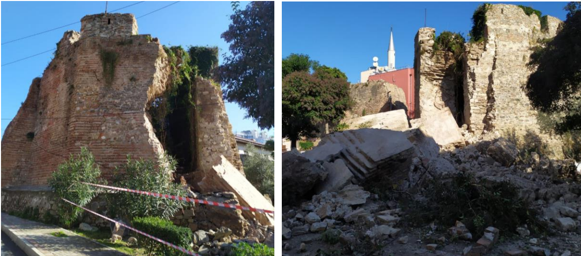
Foto e realizuar në objekt pas tërmetit
