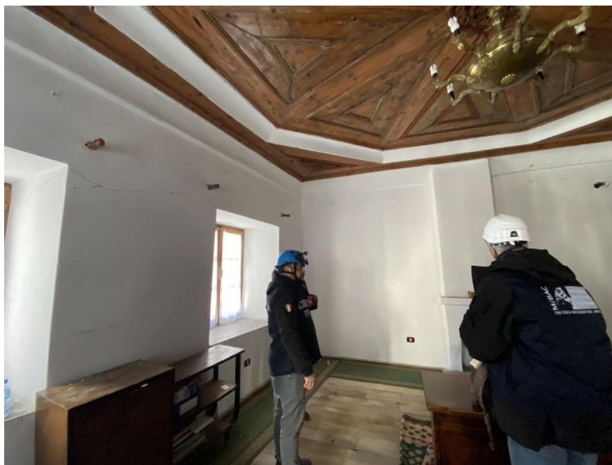
Foto e realizuar në objekt pas tërmetit
