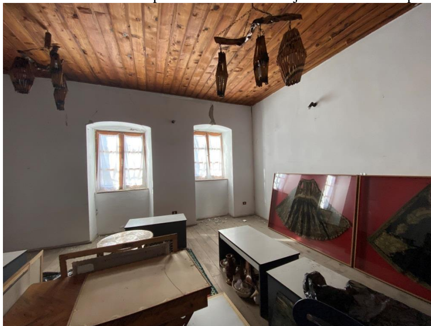
Foto e realizuar në objekt pas tërmetit
