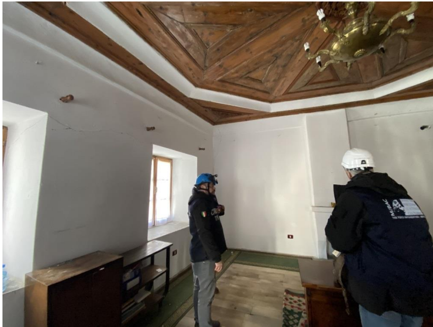
Foto e realizuar në objekt pas tërmetit
