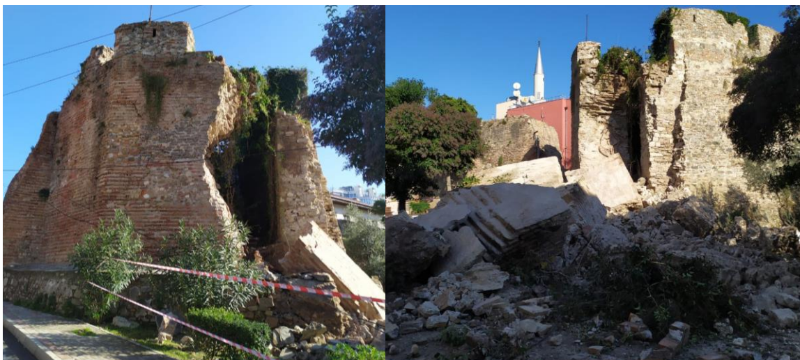
Foto e realizuar në objekt pas tërmetit
